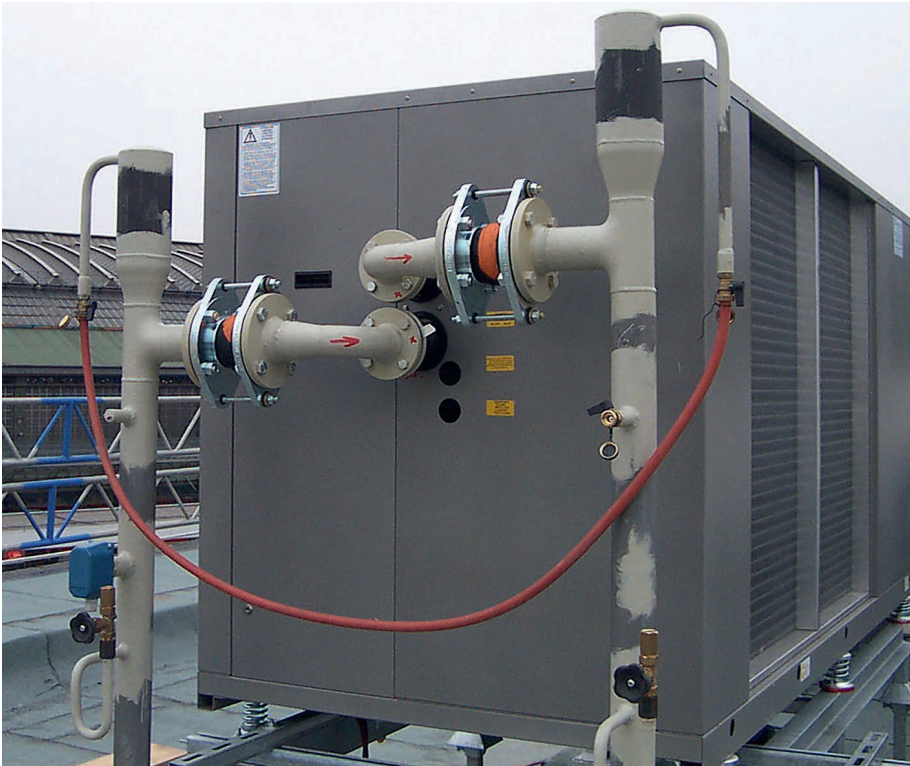
Bild 7: Lateralkompensatoren an einer kältetechnischen Anlage.
